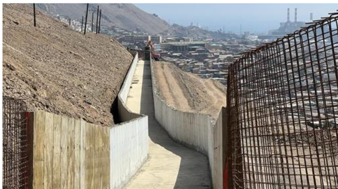
Fotografía N° 3: Vías aluvionales Tocopilla, Región de Antofagasta.
