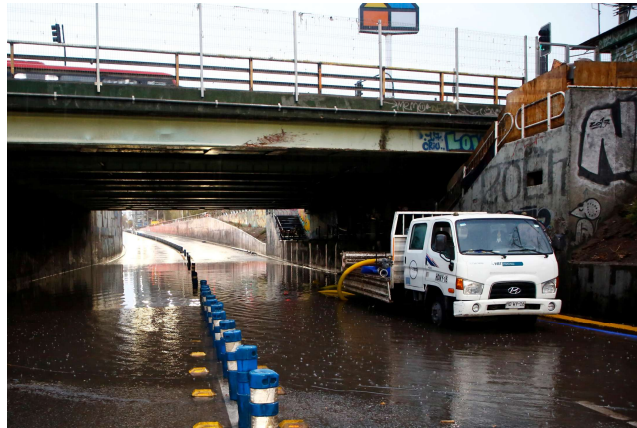
Imagen N°9: Inundación Paso bajo nivel Departamental, 2023
