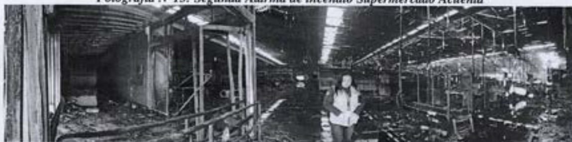
Fotografía N°13: Segunda Alarma de incendio Supermercado Acuenta
