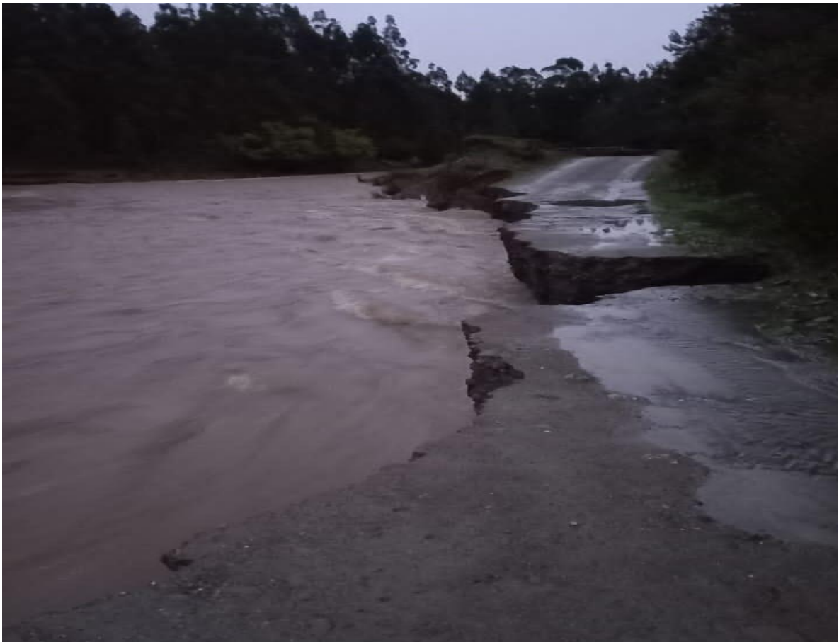
Imagen 6 Fuente: Imagen GRD. Socavón por desborde de río piren 2024.
