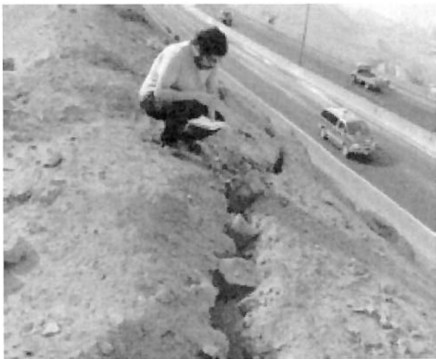
Fig. 15 Grieta sector ruta 16, Fuente: Extraído de Opazo (2014).
