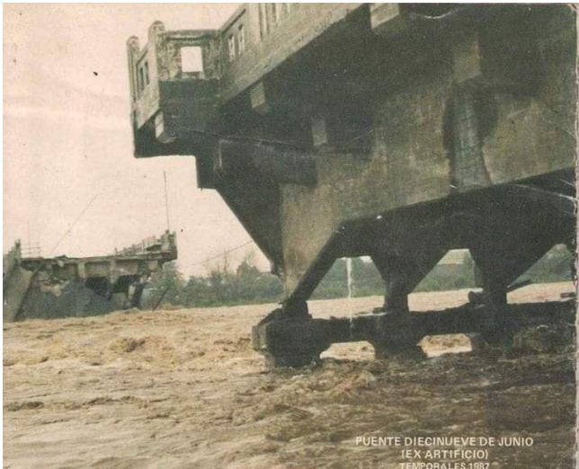
Imagen 5: Rotura de puente 19 de junio mirado por La Calera
