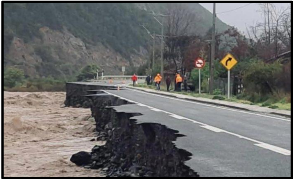
ImagenN°3 Corte de la ruta J-55km 32, sector el eucalipto Fuente: Emergencia Municipalidad de Romeral.
