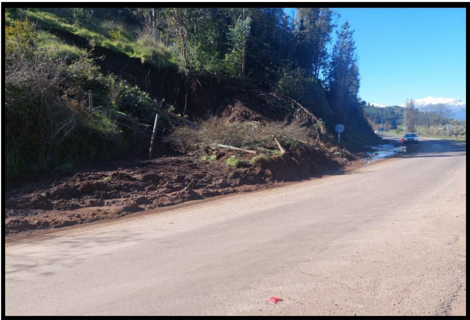
Deslizamiento de material de ladera de cerro sobre vivienda en sector La Unión Ruta J-55 km
