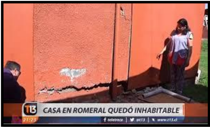
Imagen N°5 Destrucción de casa por sismo de magnitud 6.4° con epicentro en Romeral ocurrido el día 04 /11/2016
