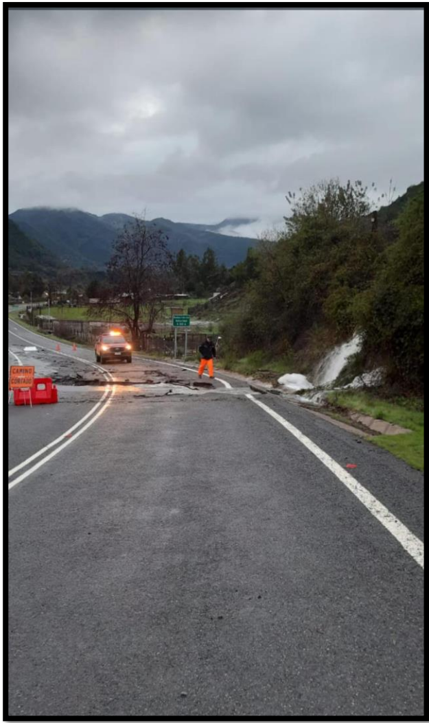
Deslizamiento de material ruta J-555 km XX provoca deterior en infraestructura vial
