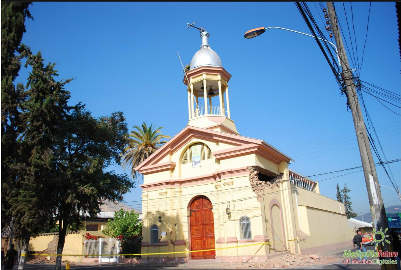
Afectación por terremoto del 27 de febrero de 2010. Fuente: Archivo digital Municipalidad de Melipilla
