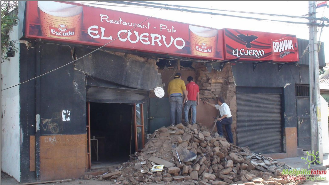
Afectación por terremoto del 27 de febrero de 2010. Fuente: Archivo digital Municipalidad de Melipilla
