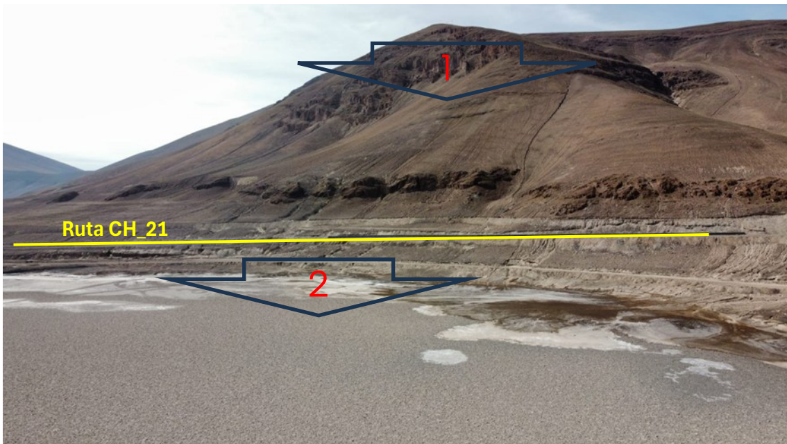
Fotografía: Probabilidad de caída de piedras por laderas y/o en bloque (Punto 1); probabilidad de socavamiento de ruta por desprendimiento inferior
