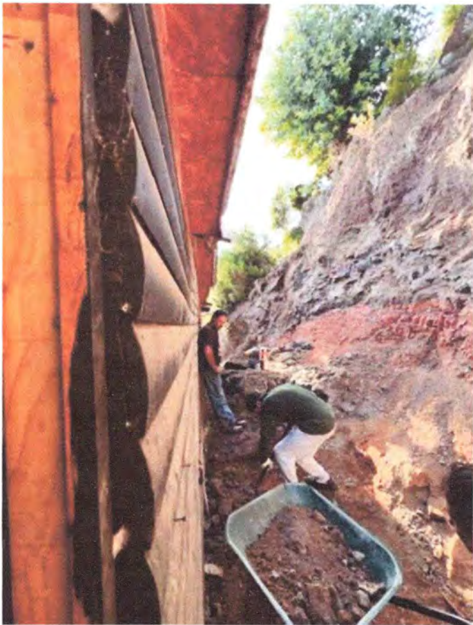
Afectación de viviendas
