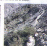
El canal de Limaxiña está completamente tapado por piedras.
