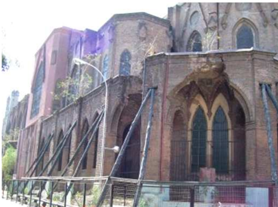
Fotografía 5: Daños aun visibles en la Basílica El Salvador, Almirante Barroso con Agustinas, Santiago
