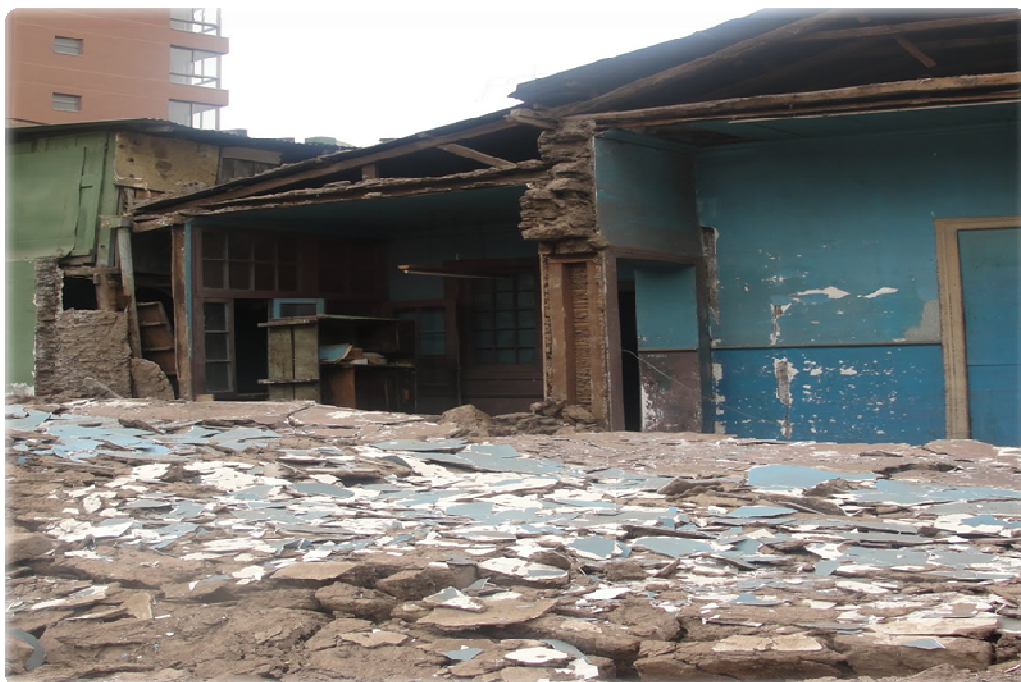
Foto 7: Vivienda colectiva donde residían migrantes que quedó inhabitable a raíz del terremoto.
