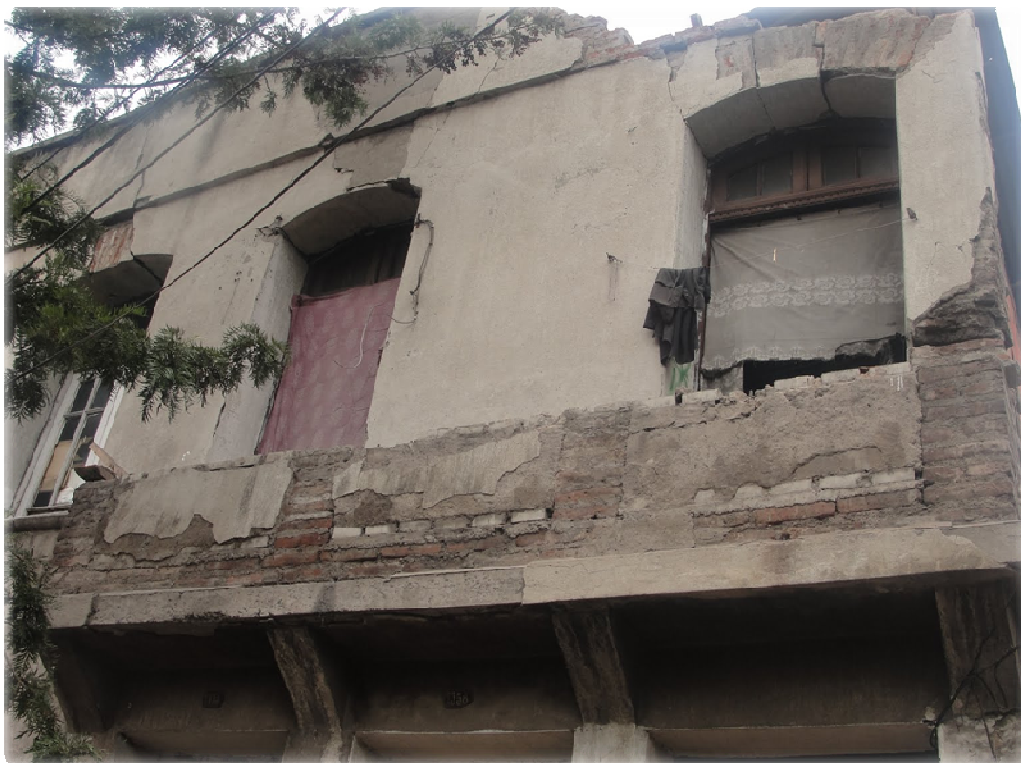
Foto 12: Hospedería de migrantes en condiciones de alto riesgo tras el terremoto.
