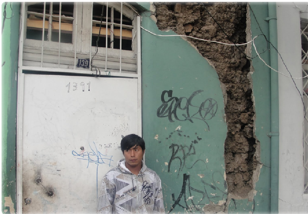
Foto 3: Migrante frente a una vivienda afectada por el terremoto en Santiago
