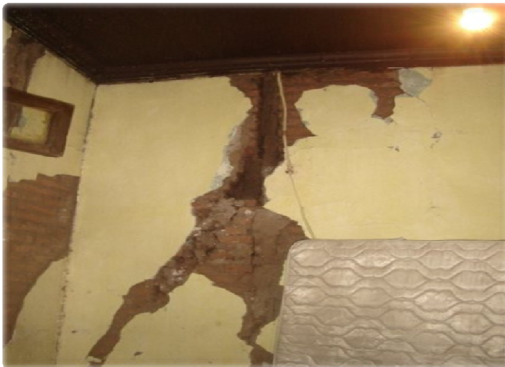
Foto 9: Habitación de una familia migrante en Santiago Centro, con paredes con serios daños tras el terremoto.
