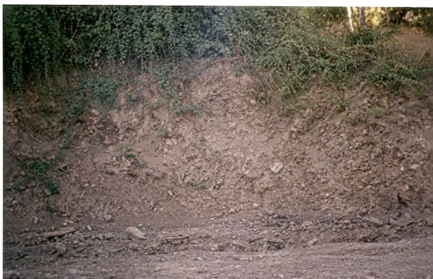
Fotografías N°8: Corte Talud
