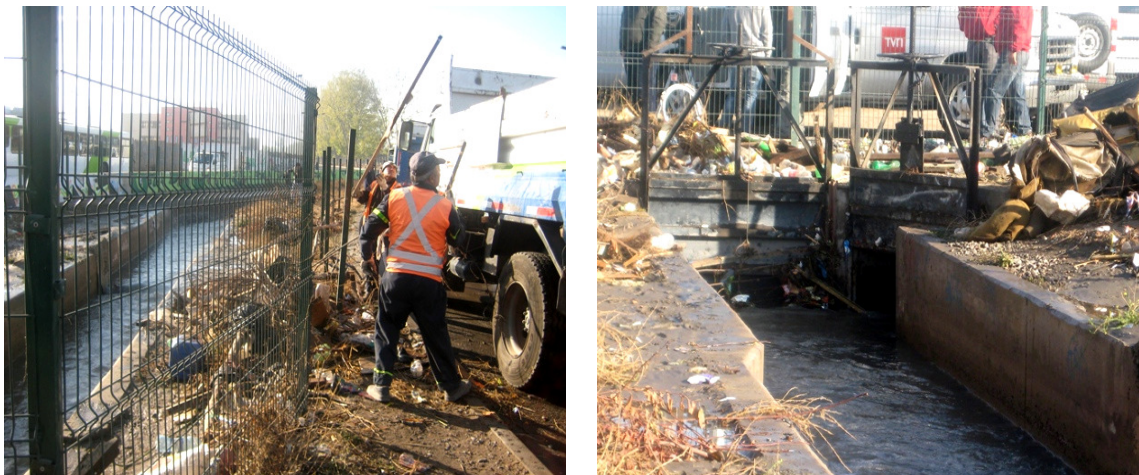
Fotografía 11: Desborde del Canal Ortuzano, mayo 2009.
