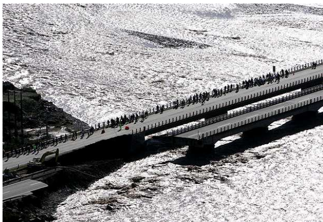
Fotografía 7: Se observa el daño de la pista norponiente del puente Teno que generó La interrupción del tránsito por la ruta 5.
