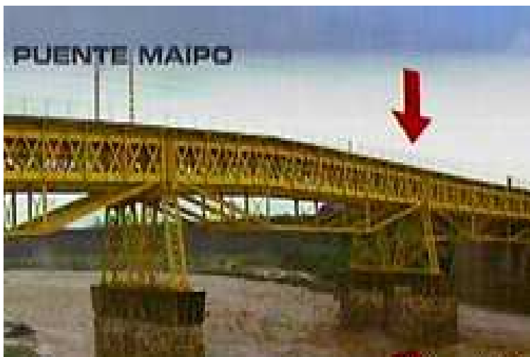
Fotografía 6: Vista que muestra el punto donde fue afectada la línea férrea en el puente Maipo.
