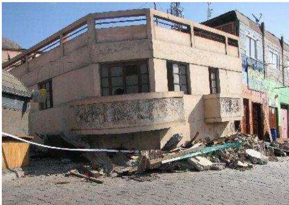
Fotografía 2: Destrucción primer piso vivienda en Ovalle.
