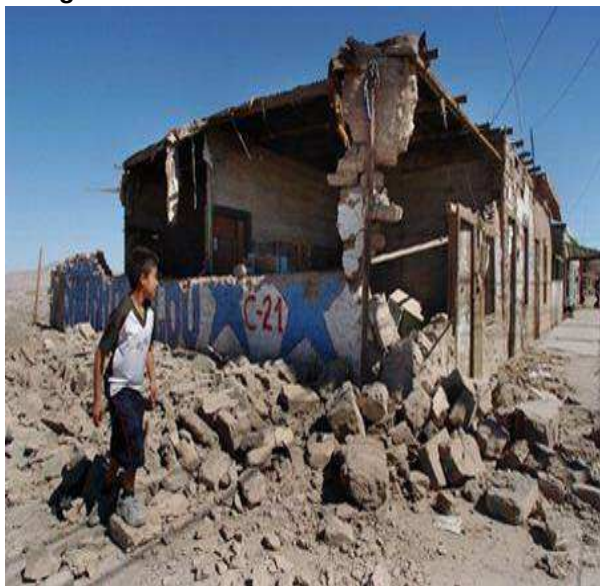
Fotografía 3: Vivienda de adobe inhabitable en Tarapacá.
